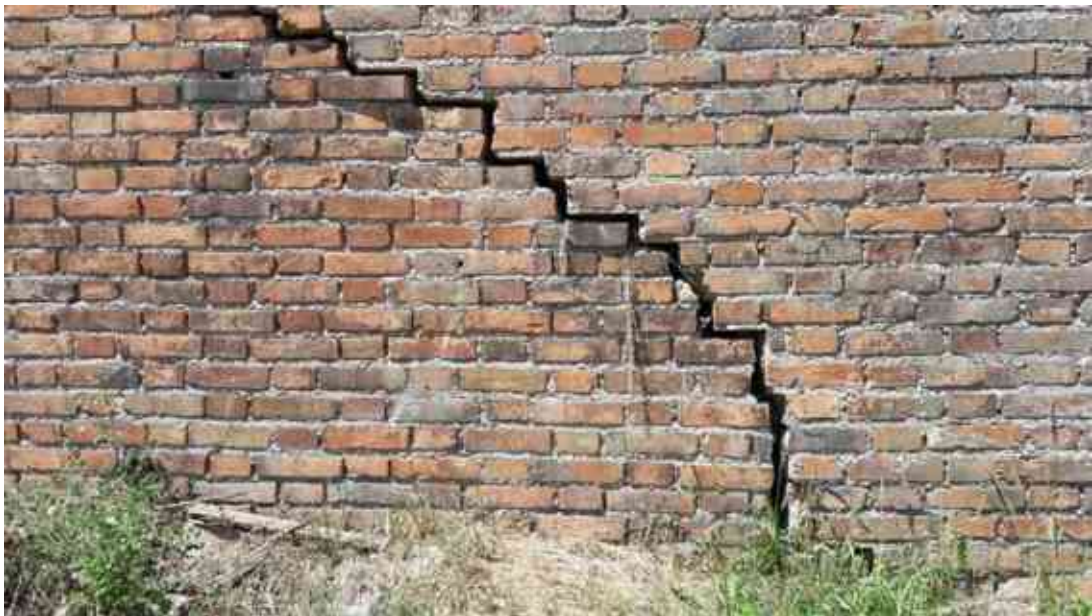
FOTO 8 – Lesione muro di contenimento lato est
