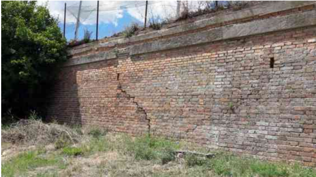
FOTO 1 – Lesione muro di contenimento lato est
