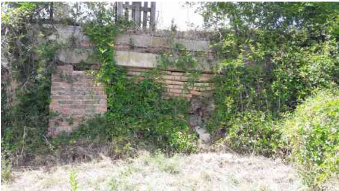
FOTO 30 – Porzione di muro di contenimento crollato lato est
