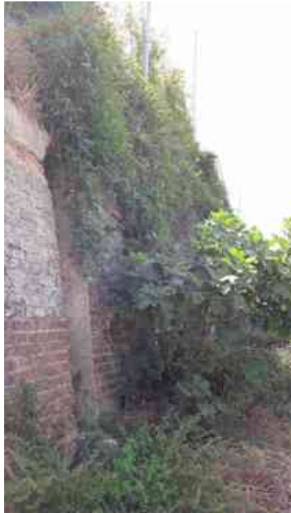
FOTO 9 – Distacco tra strutture portanti non ammorzate muro di contenimento lato nord
