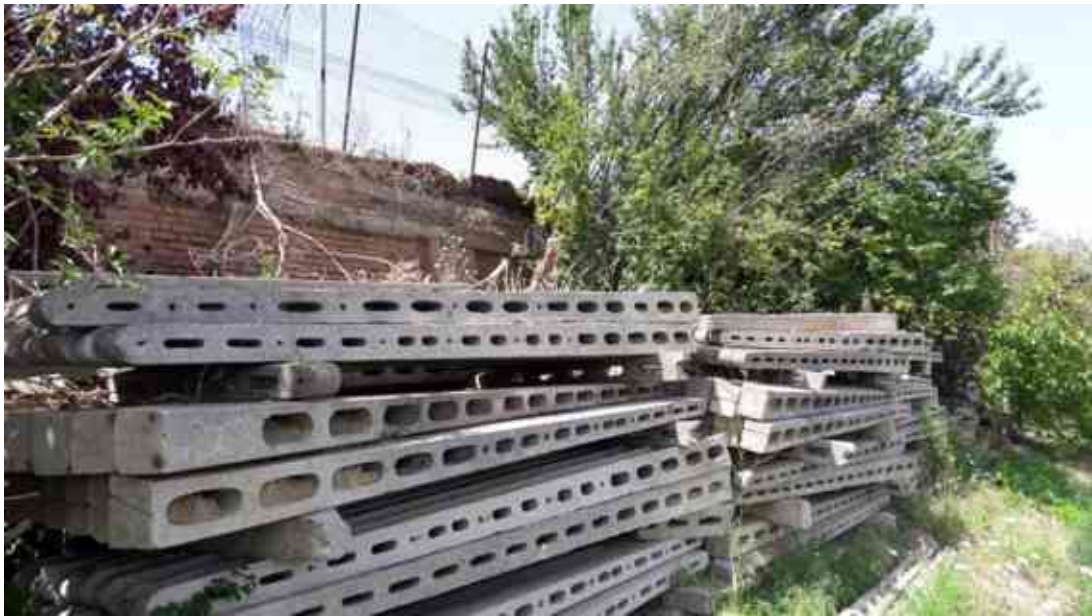
FOTO 34 – Porzione di muro di contenimento sommerso dalla vegetazione e da tralicci di vigneto
