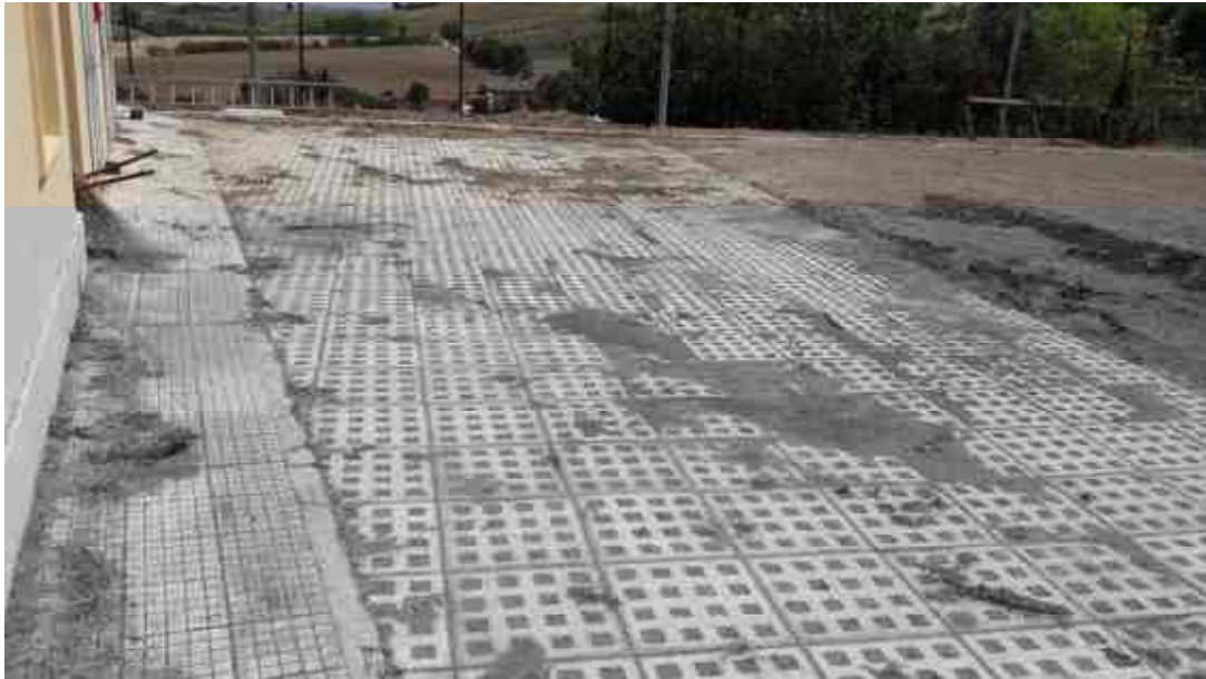
FOTO 55 – Pavimentazione esterna fronte spogliatoi
