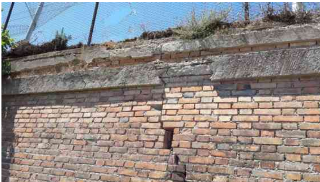
FOTO 6 – Ammaloramento cordoli e lesione muro di contenimento lato est
