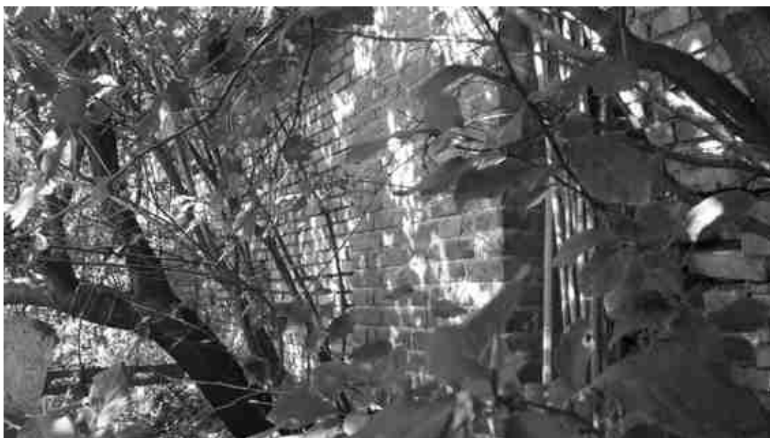
FOTO 47 – Porzione di muro di contenimento visibile tra la vegetazione ed i tralci di vigneto
