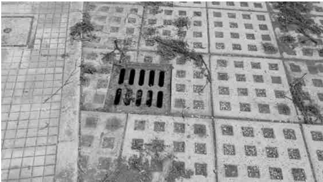
FOTO 56 – Pavimentazione esterna e caditoia esistente
