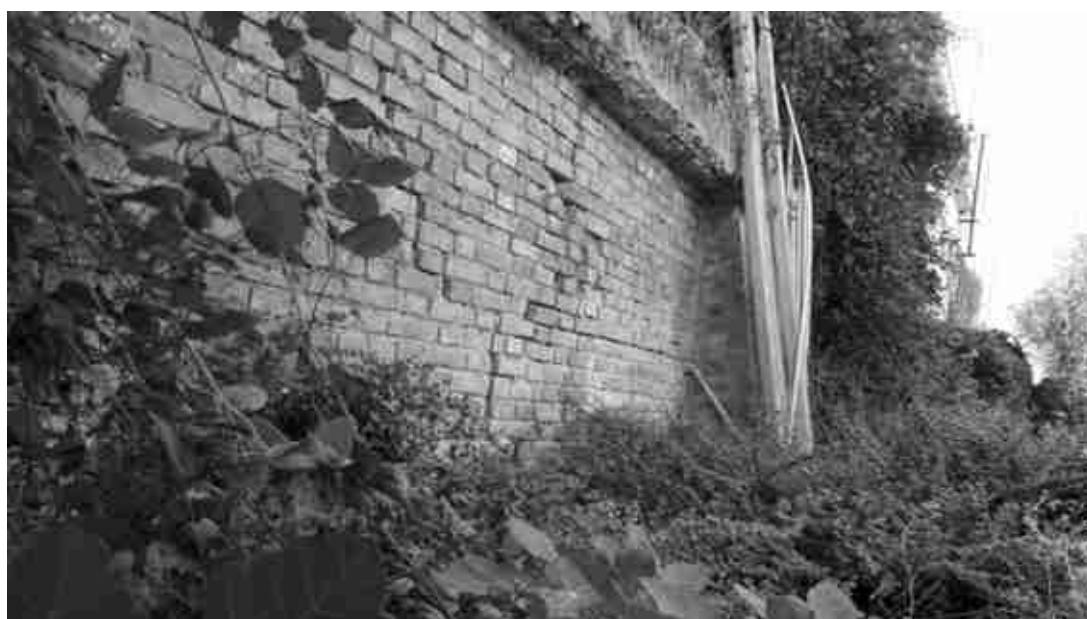
FOTO 12 – Muro di contenimento lesione lato nord
