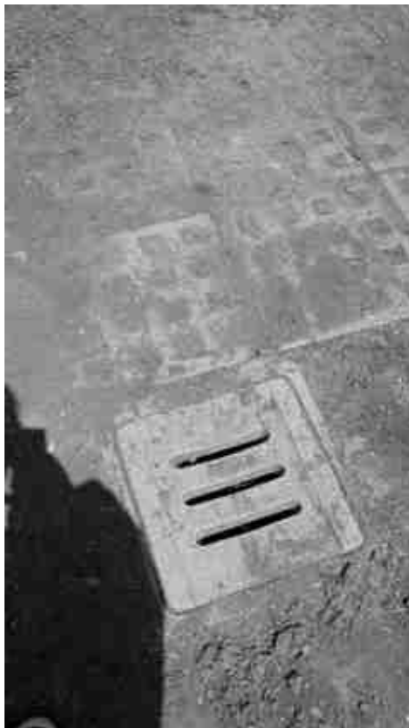
FOTO 58 – Pavimentazione esterna e caditoia esistente
