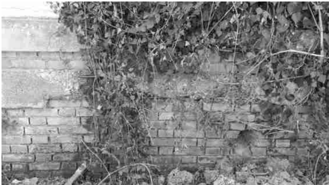
FOTO 26 – Ammaloramento cordolo muro di contenimento lato nord
