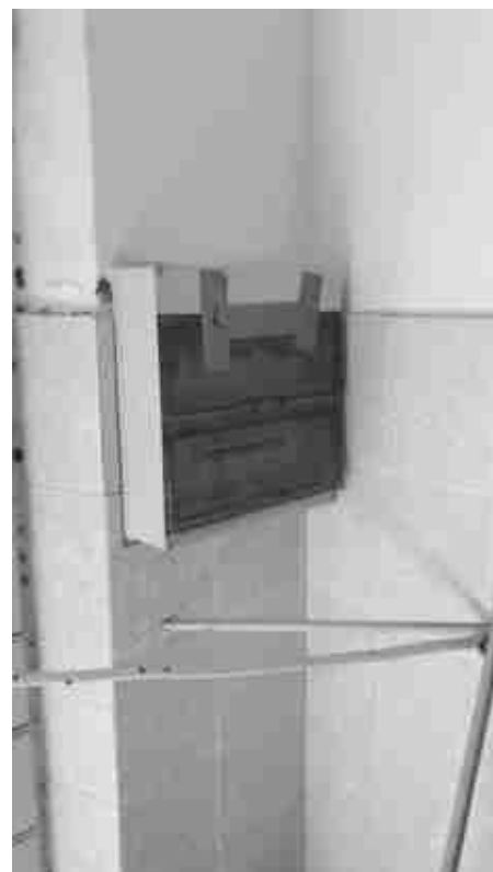
FOTO 88 – Ingresso spogliatoi quadro elettrico
