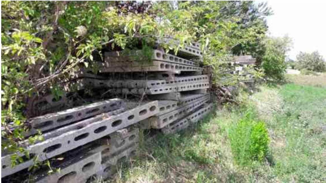
FOTO 33 – Porzione di muro di contenimento sommerso dalla vegetazione e da tralicci di vigneto
