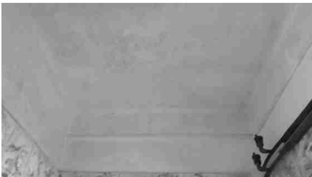
FOTO 76 – Soffitto docce tinteggiatura degradata e presenza di muffe
