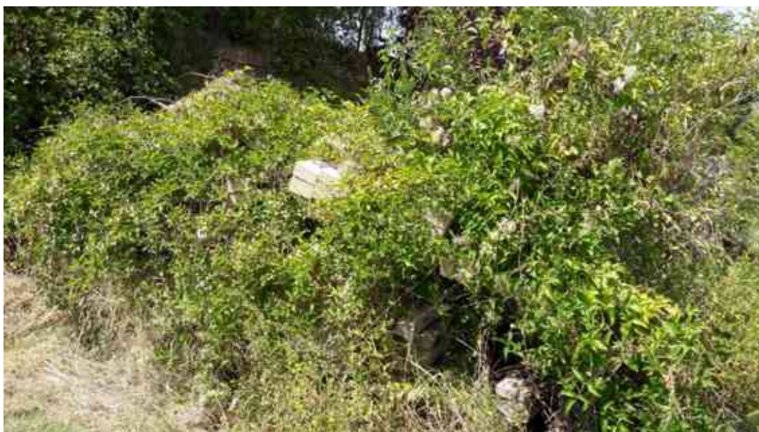
FOTO 31 – Porzione di muro di contenimento sommerso dalla vegetazione e da tralici di vigneto
