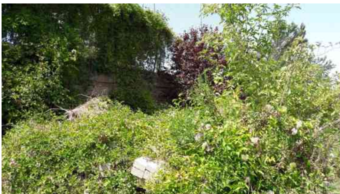
FOTO 32 – Porzione di muro di contenimento sommerso dalla vegetazione e da tralici di vigneto
