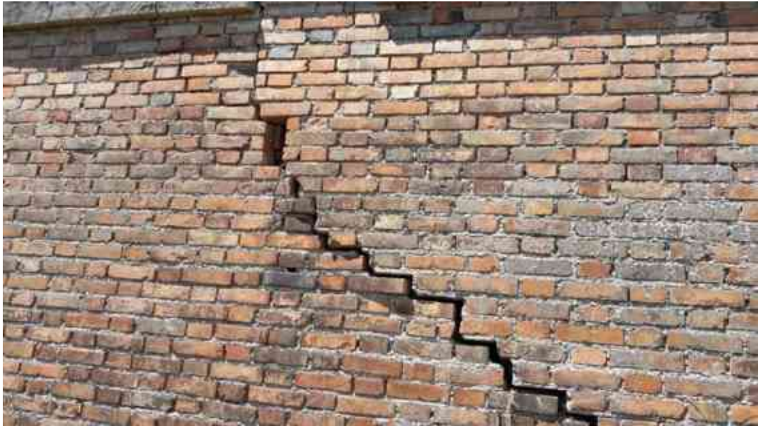
FOTO 7 – Lesione muro di contenimento lato est
