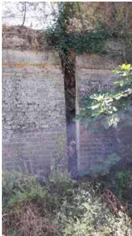
FOTO 10 – Distacco tra strutture portanti non ammorzate muro di contenimento lato nord
