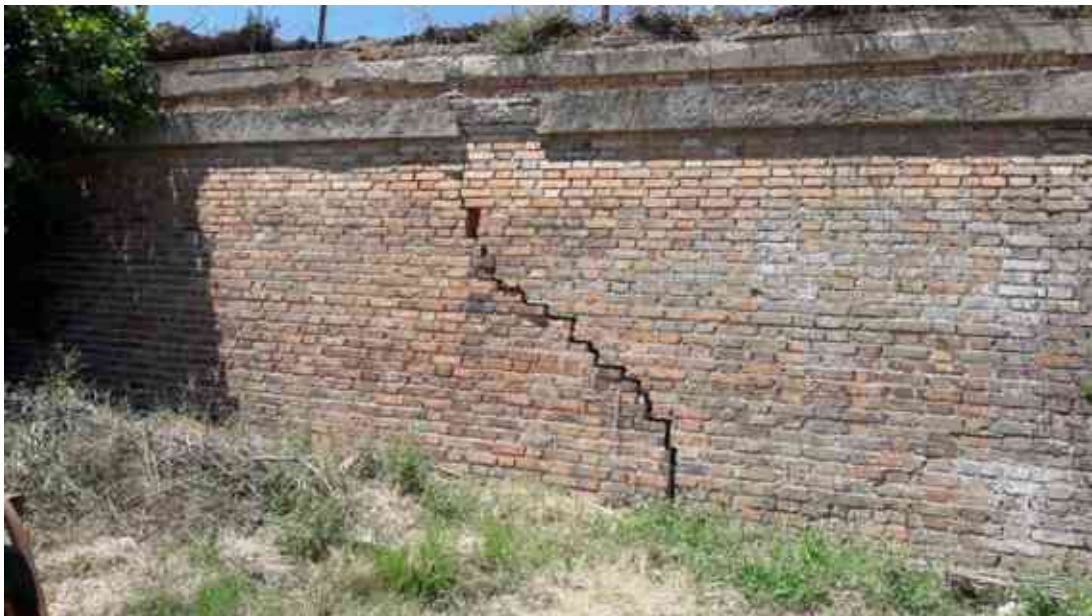
FOTO 4 – Lesione muro di contenimento lato est
