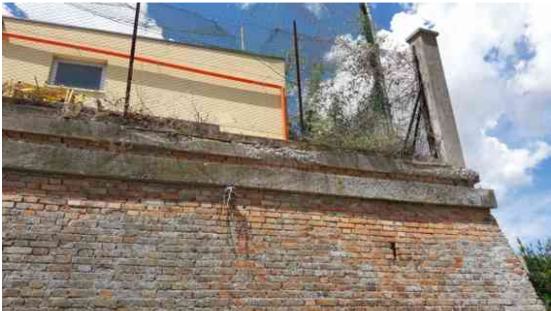
FOTO 2 – Ammaloramento cordoli muro di contenimento lato est
