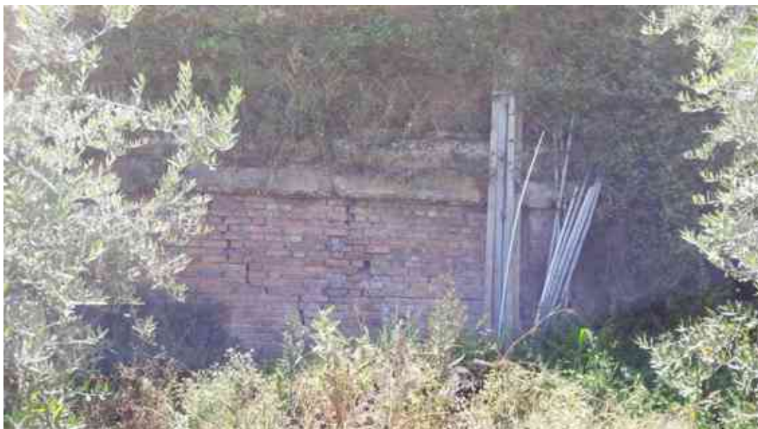
FOTO 13 – Muro di contenimento lesione lato nord
