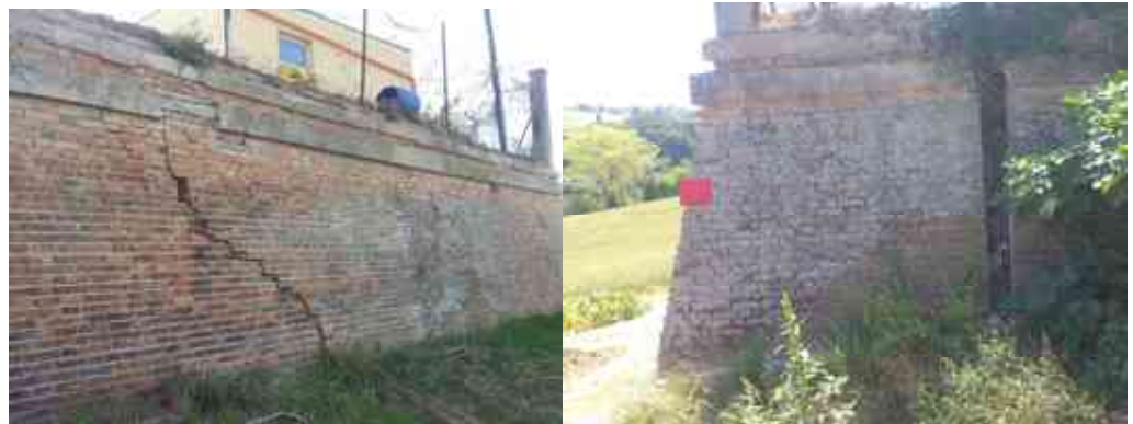
Figura 2 – Tratto di muro di contenimento lesionato.
