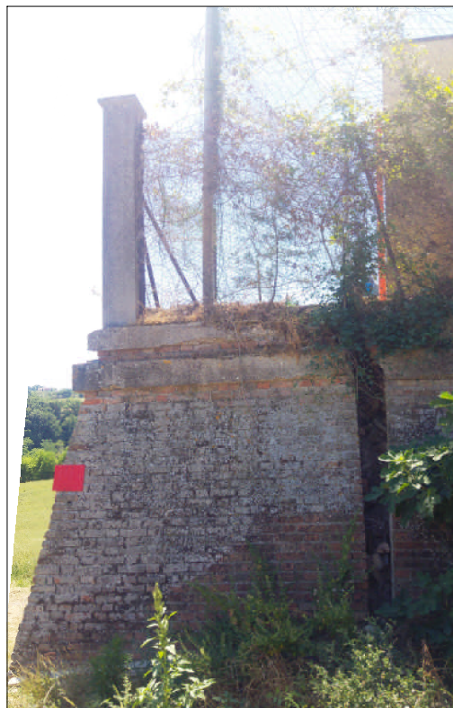
Foto 2 : Particolare del muro dissestato oggetto di intervento.
